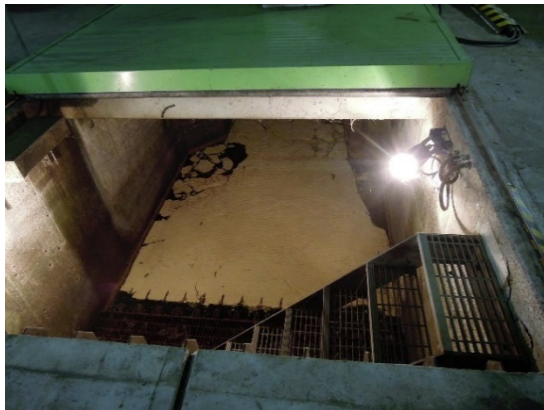
水再生センターに流入した油
